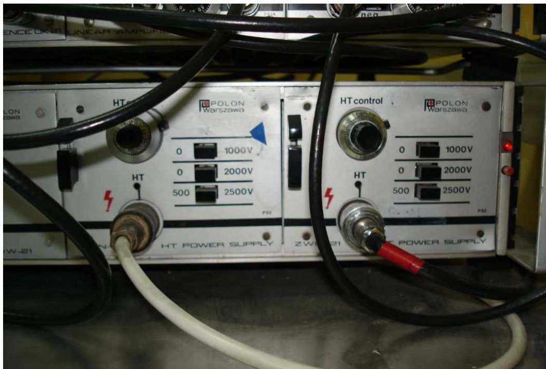
Fot. 2. Zasilacze wysokiego napięcia ZWN-21.
